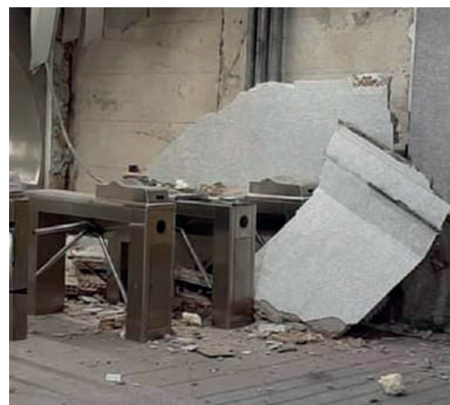
26 Settembre 2020 | Crollo nella stazione metro Salvator Rosa a Napoli a causa delle infiltrazioni d'acqua
