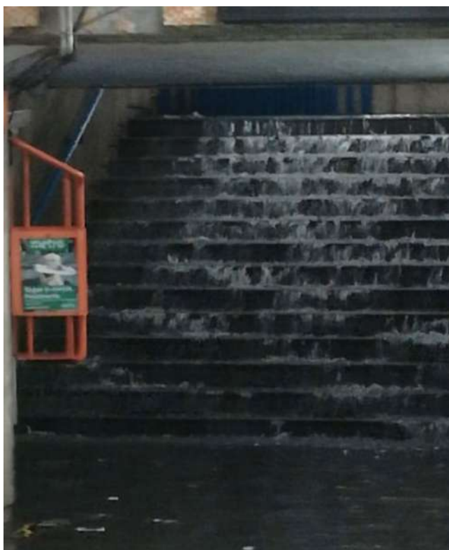
24 gennaio 2021 | Le forti piogge allagano, ancora una volta, la stazione metro Cipro
